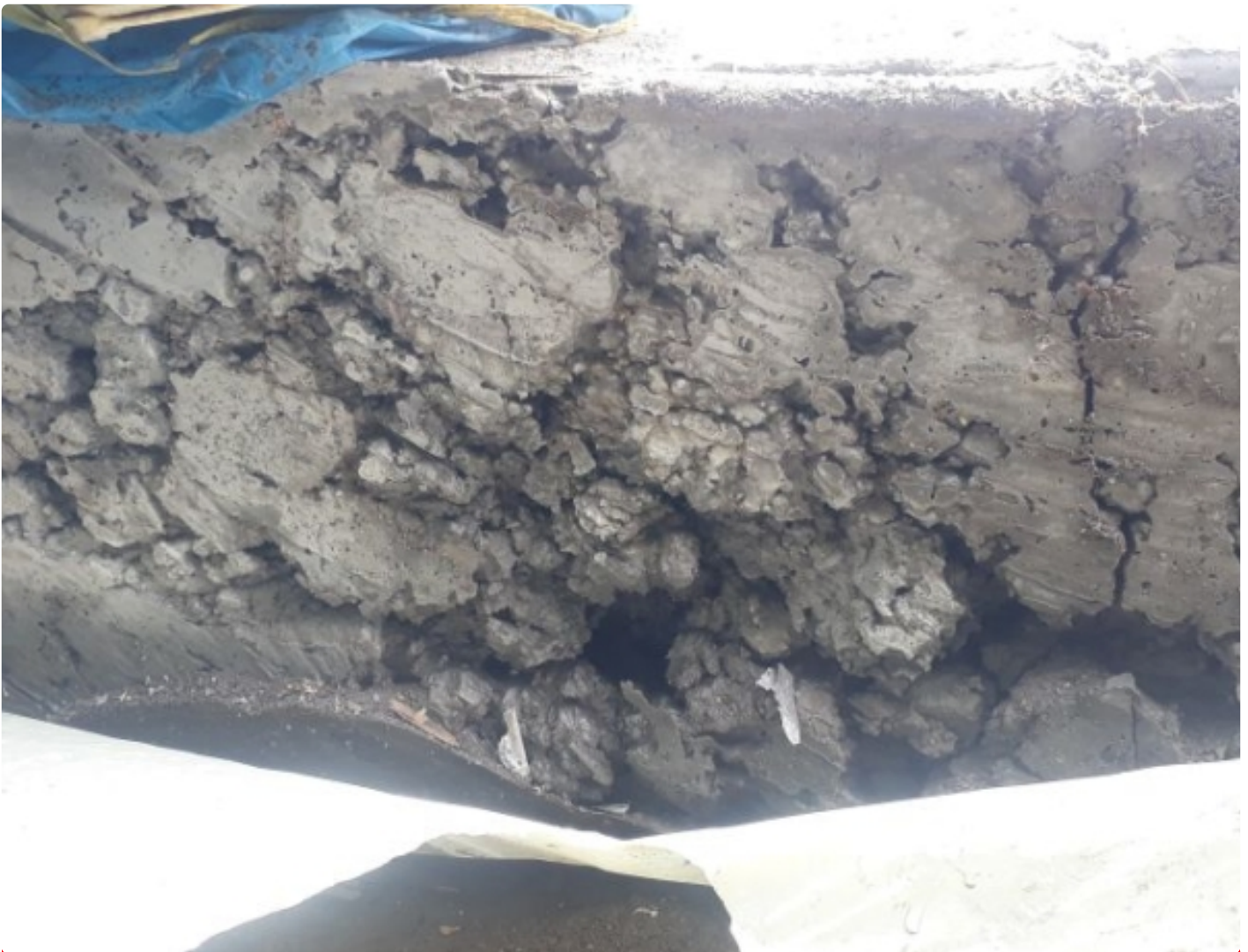
Terlihat kondisi keropos pada struktur jalan
